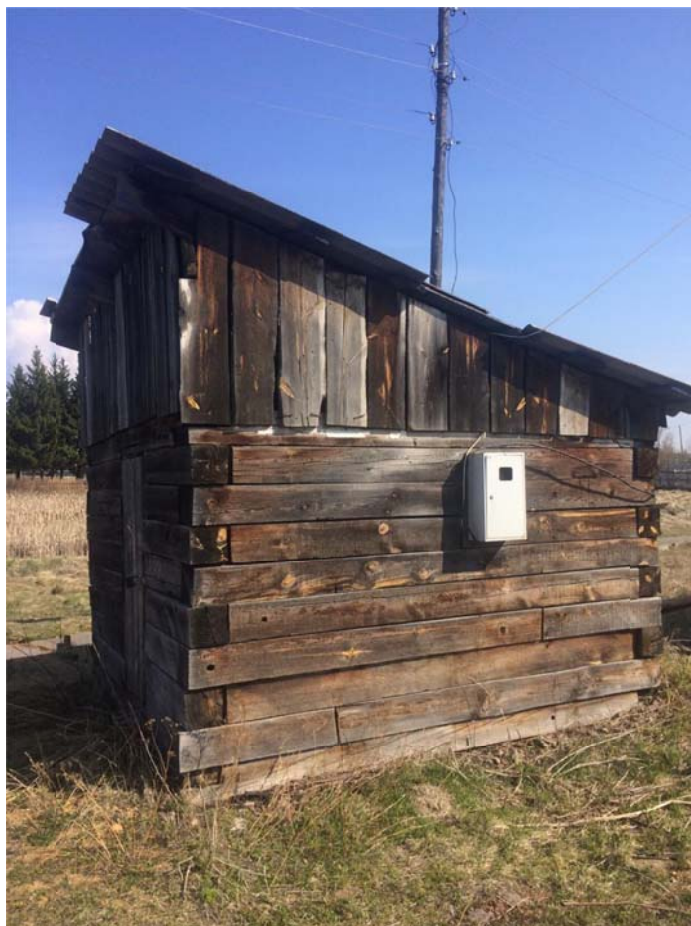
Фото 2. Следы разрушения шифера, вводной кабель не зафиксирован к стене.
