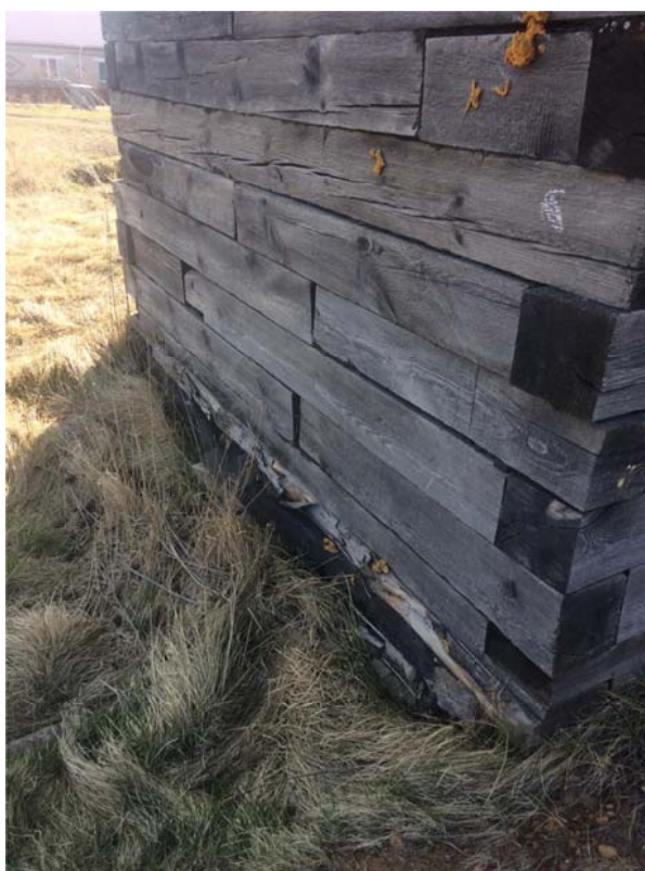
Фото 3. На стенах трещины, зазоры между брусом.
