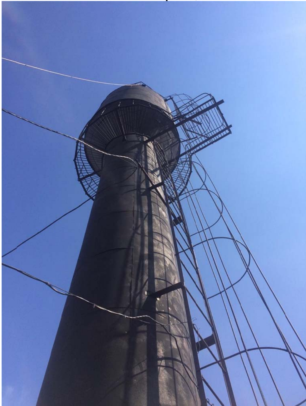
Фото 1. Водонапорная башня Интернациональная 2а. Следы коррозии и деформации металла.
